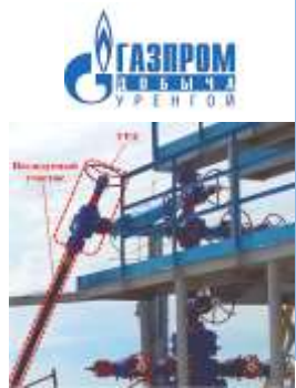
ТРУБОПРОВОДЫ ГАЗОВОЙ ИНФРАСТРУКТУРЫ
